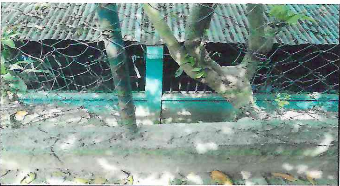
Foto 3: Deterioro de muro perimetral
