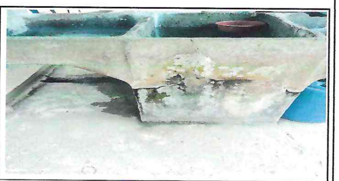
Foto 6: pila en deterioro
