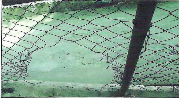
Foto 1: Malla del muro perimetral con agujeros
